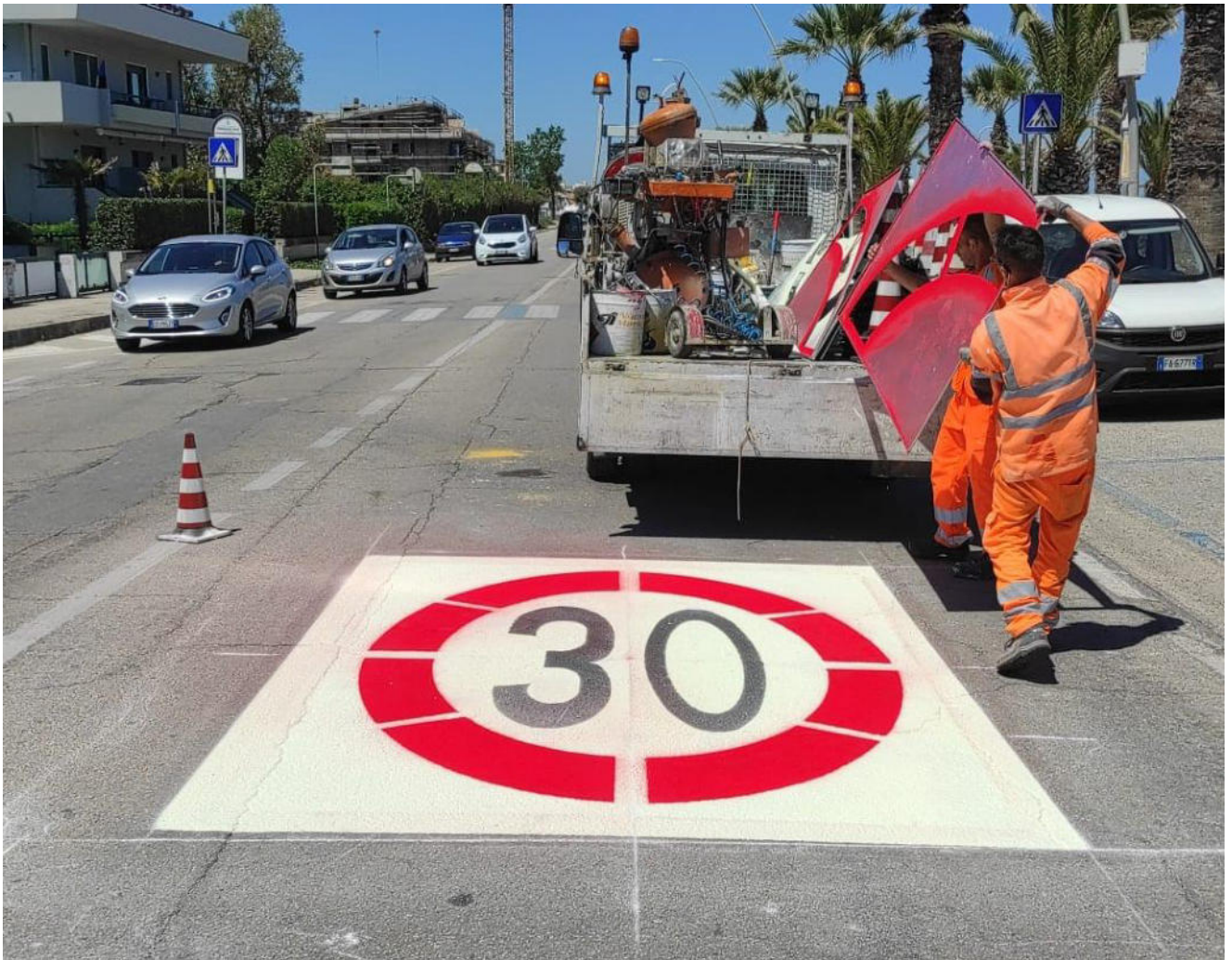
Realizzazione di segnaletica 30 kmh di grande formato sul lungomare di Tortoreto (TE), mediante resine antiscivolo e maschere.
